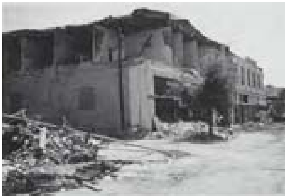
شکل ۹-۱ دیوار بیرونی تخریب شده طبقه دوم یک ساختمان در ناحیه محدوده مرکز شهر کاملاً ویران شده کولینگا. زلزله: کولینگا، CA ۲ می ۱۹۸۳.
