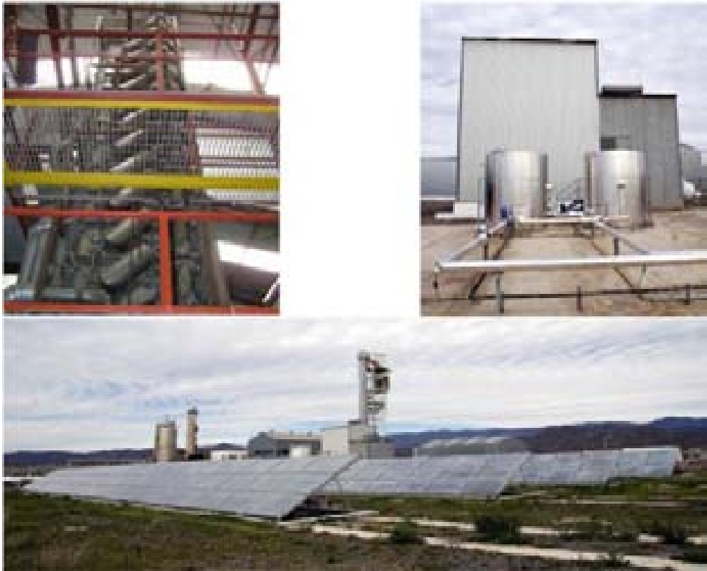
شکل 1-8 آب شیرین کن MED، سیستم ذخیره سازی و کلکتورهای خورشیدی سهموی در پلتفرم خورشیدی آلمریا (Plataforma Solar de Almería) PSA
