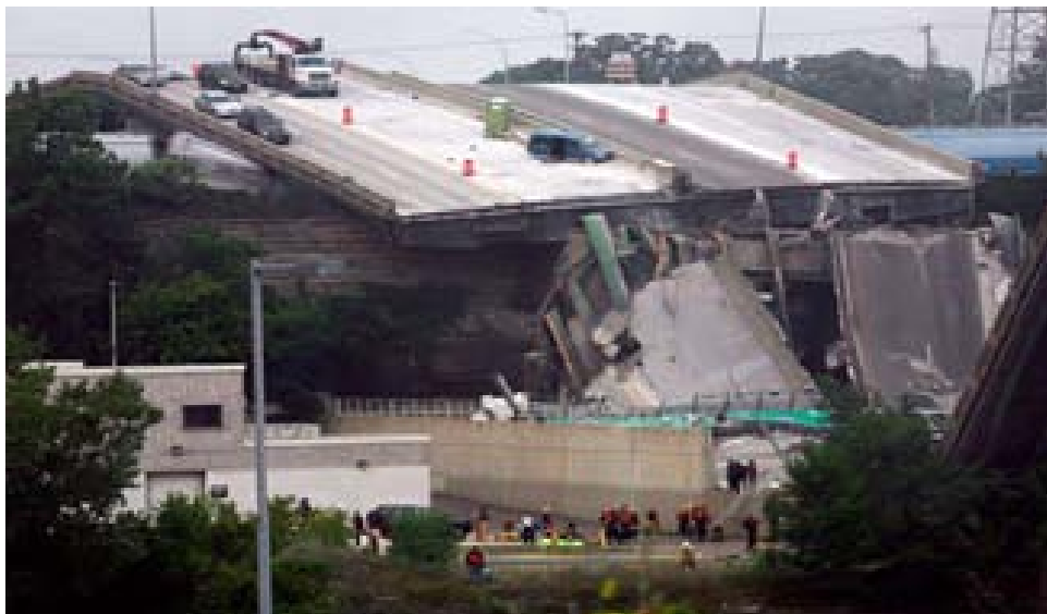
شکل ۳-۱: آسیب عمده کوله پل
